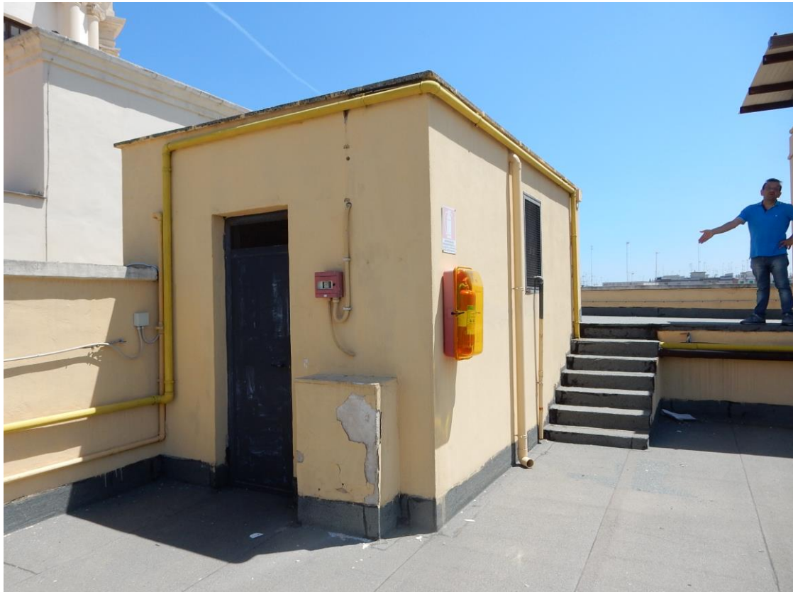
Foto 15: centrale termica in copertura
