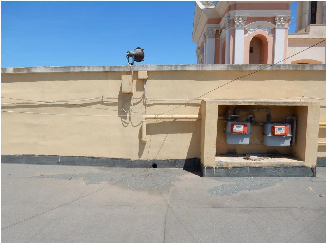
Foto 17: centrale termica in copertura
