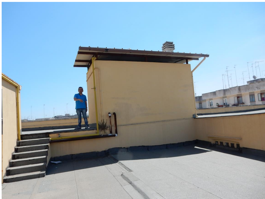
Foto 16: centrale termica in copertura
